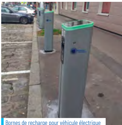
Bornes de recharge pour véhicule électrique du réseau Métropolis.
